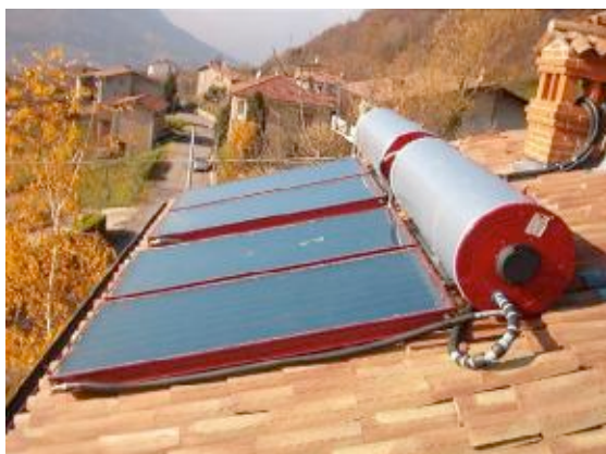
Figura 4: tipico collettore solare termico.
