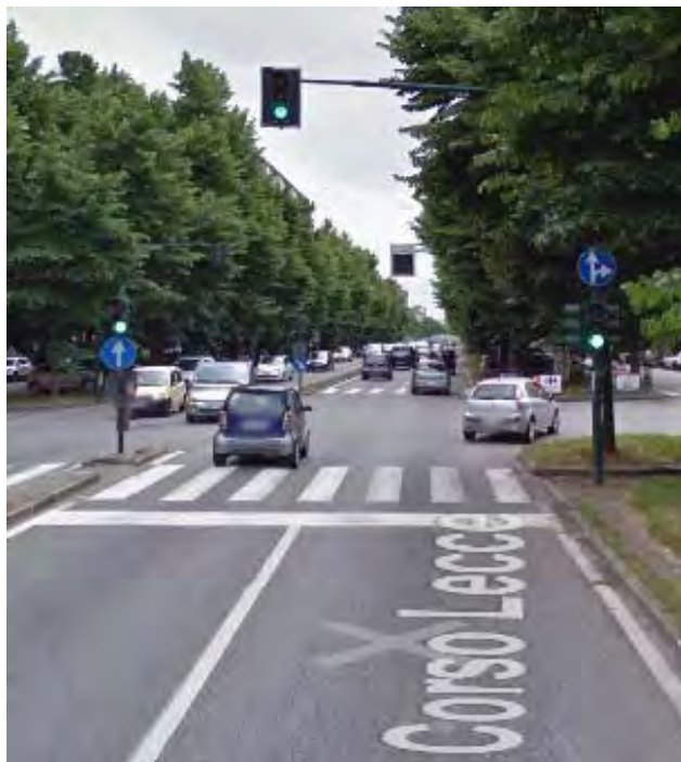
Impianto con lanterne a LED
